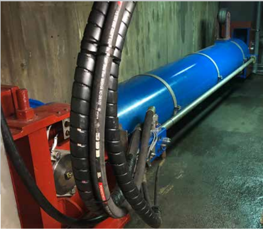
Broer skal til stadighed vedligeholdes. I 2018 udskiftedes de to 5 ton store cylindre, som hæver den tunge bro på mindre end to minutter (S. H. Group).
