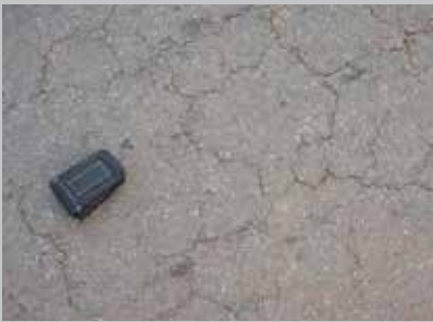
Den danskbyggede vej blev nedbrudt. Fotografierne viser vejens belægningskader. Foto NIRAS 2008.
